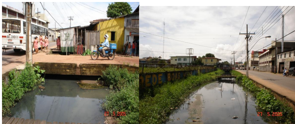
Fig 15 e 16: Situação atual da Avenida Bernardo Sayão (Estrada Nova). Canais abertos e suscetíveis a transbordamento. Fonte:BELÉM, 2006 a.
